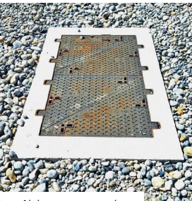
Chambre d'atterrissage du câble sous-marin
